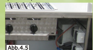
Abb: 220 V Verteilerkasten mit F.I. Schalter Sicherungsautomaten und Steckdosen.
